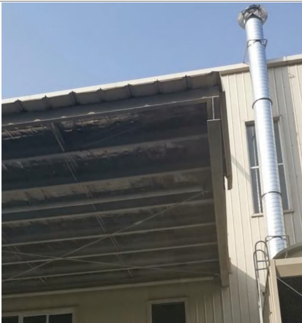
DA001 有机废气排气筒
