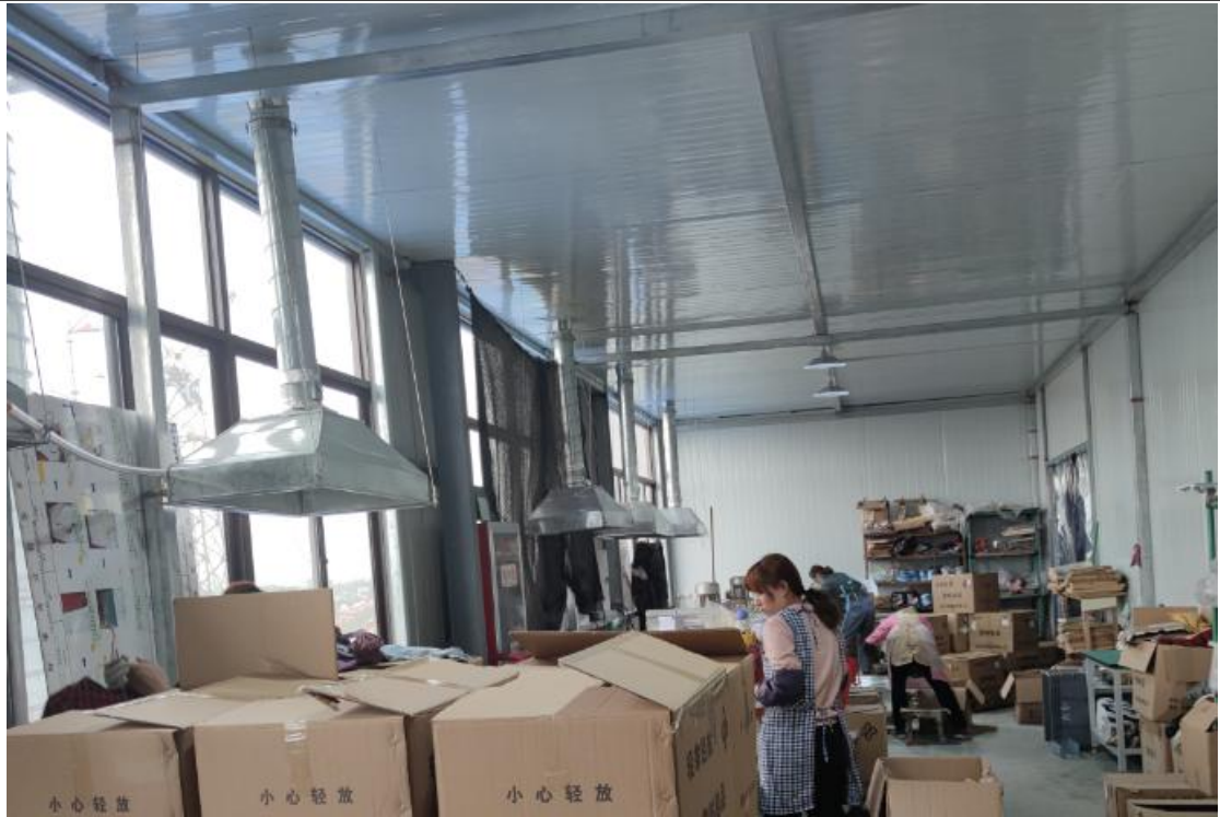
封闭式丝印车间+集气系统
