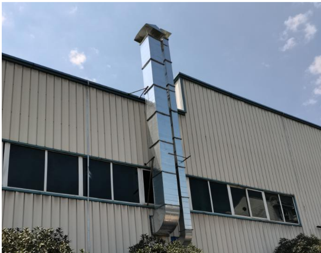
15m 高排气筒
