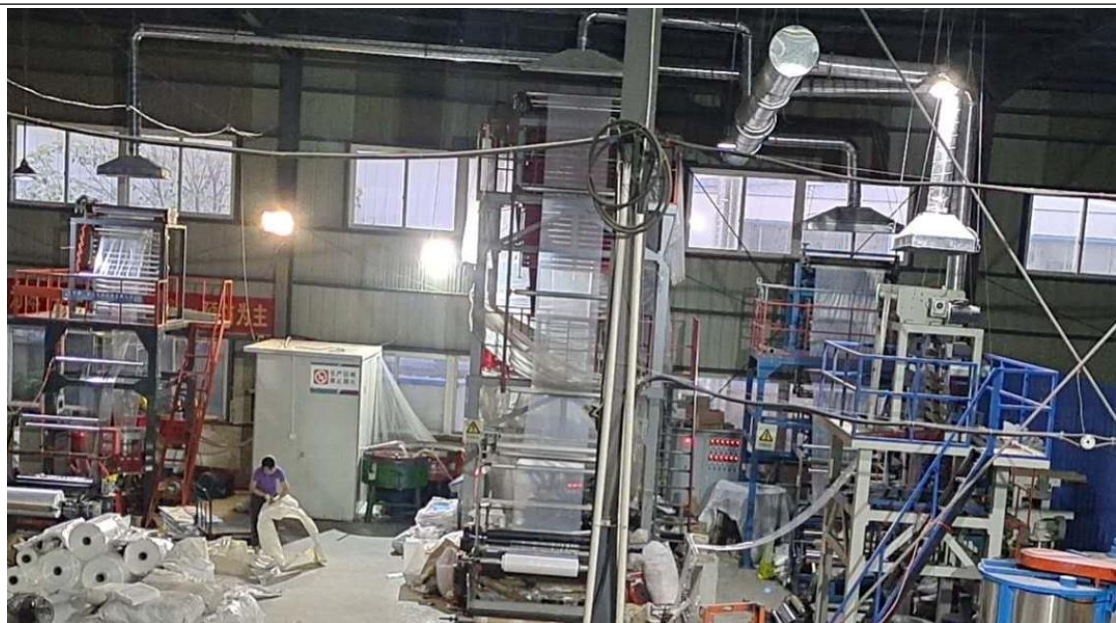
有机废气收集系统
